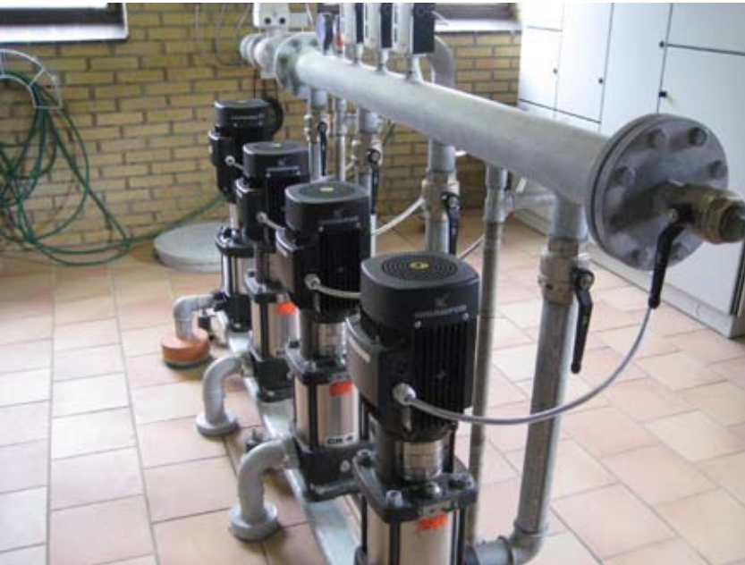
Rentvandspumper på Almind Vandværk.
