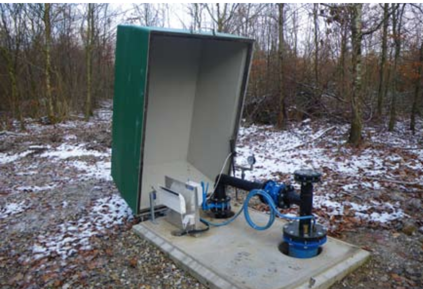
Råvandsstation – Vonsild Vandværk.
