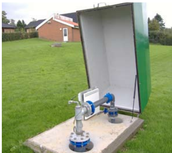
Råvandsstation ved Ødis Vandværk.
