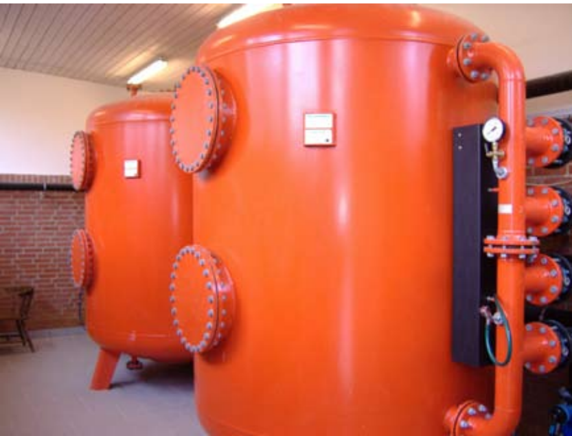
Lukket filteranlæg på Vester Nebel Vandværk.
