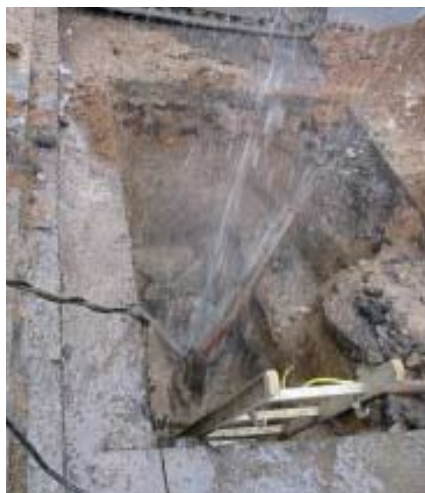
Brud på ledningsnet
