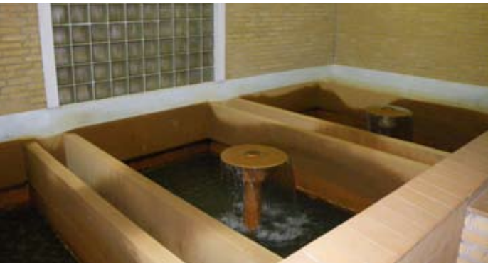
Åbent filteranlæg på Bramdrupdam Vandværk - Sønderholm.
